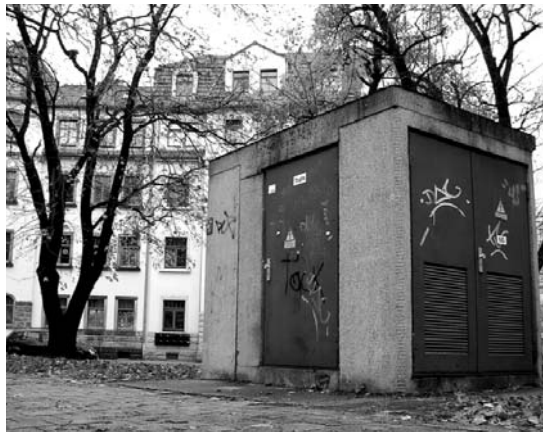
Alte Trafostation auf der Grillparzer Straße.
