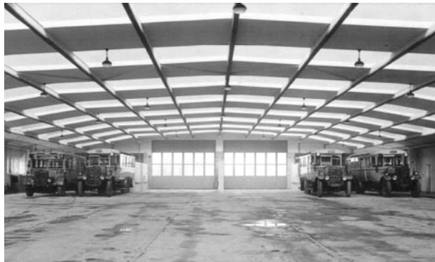
Die Dachkonstruktion der 1939 fertig gestellten Wagenhalle des Omnibusbetriebshofes Naußlitz war eine reine Holzkonstruktion! Foto: DVB
