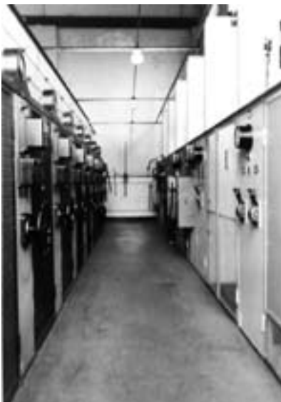
Links im Bild der Schaltschrank für 10 kV, rechts der für 20 kV.
