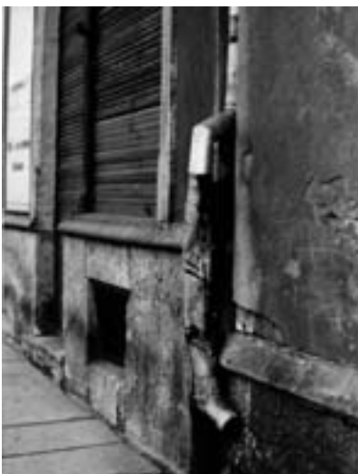
Improvisiert - der Wasserabfluß.
